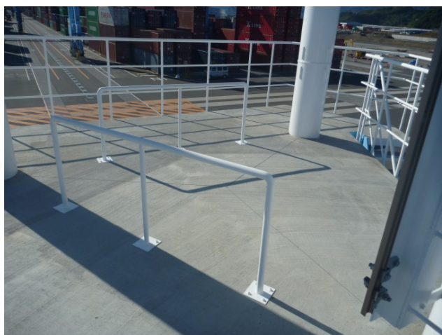
25人収容できる避難デッキ
